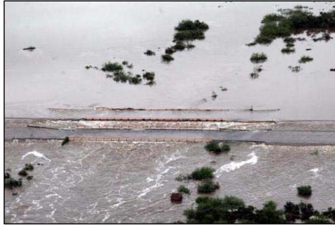
Puente de la autopista sobre el arroyo Colastiné, afectado por lluvias extraordinarias
